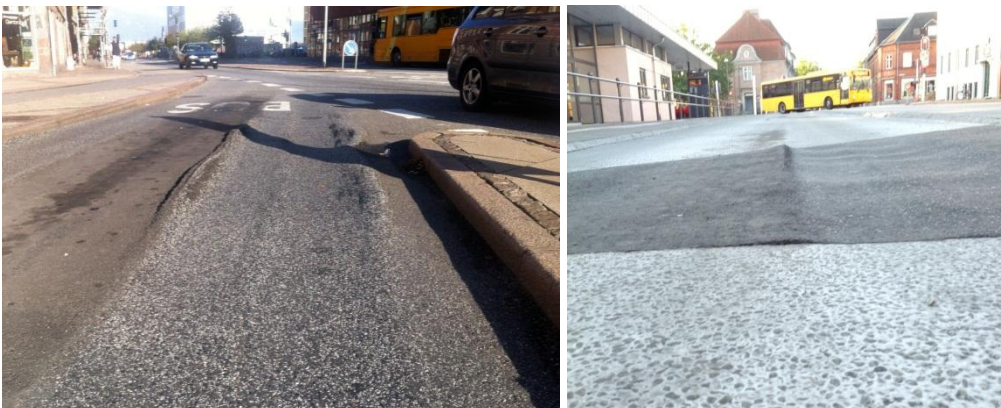
Figur 2. 1: Kraftig sporkørsel ved holdeplads på Kennedy Plads i Aalborg. 2: Eksempel på semifleksibel belægning afbrudt af asfalt ved Næstved Station. Sporkørsel forekommer kun i asfaltbelægning.
