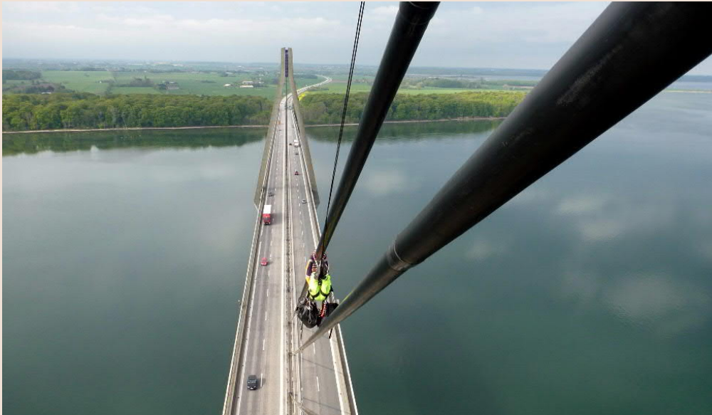
Farøbroen – Inspektion af skråstag.
