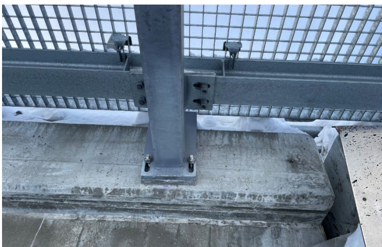
Figur 5: Billede af forankring af gangbro ved brovederlag. Bemærk langhuller under gangbroens længdebjælker, samt fugegab på ca. 10 cm ved broende.
