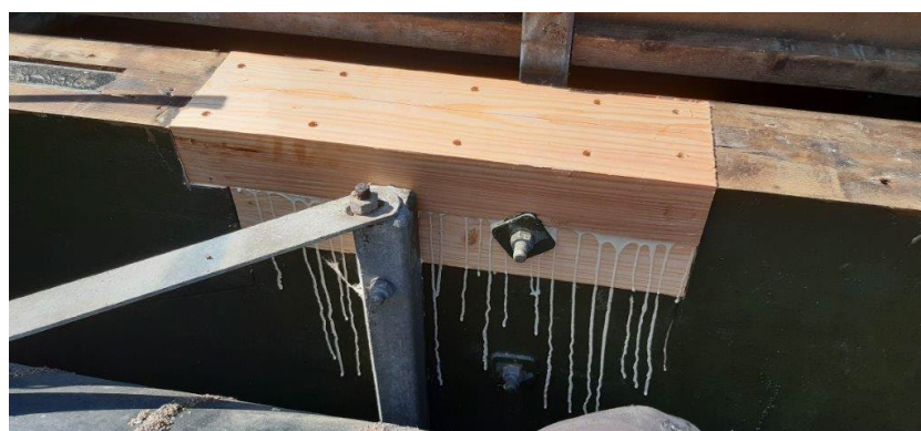
Fig. 2: Træbroer kan gemme på skjulte skader. Broen her, som har vanger i limtræ(fyrretræ), fik nye dækplanker i 2019. I den forbindelse fandt vi et par rådskeer i limtræet, som blev repareret.
