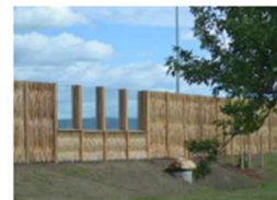
Støjskærm med afbarket pilefacade og transparent felt
