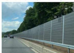
Støjskærm med kassetter i aluminium
